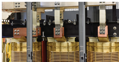
Bus de baja tensión
