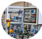
Temporizadores, soneloides y controladores
