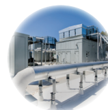
Chauffage, ventilation et climatisation (CVC)
