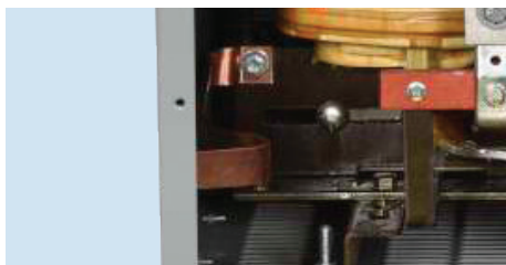
Tomas de tierra principales instaladas en fábrica
