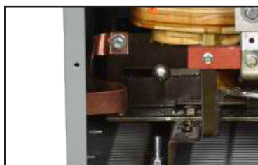
Cosses de mise à la terre principale installées en usine
